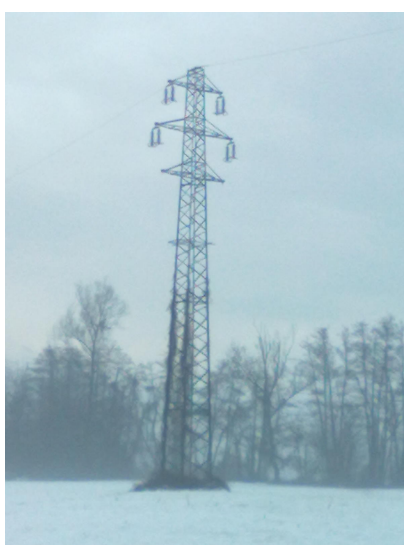
Figura 11 Foto di un pilone della linea elettrica NNW-SSE, di proprietà della società IREN spa, in disuso. Il pilone è sprovvisto dei cavi di trasmissione della corrente elettrica.
